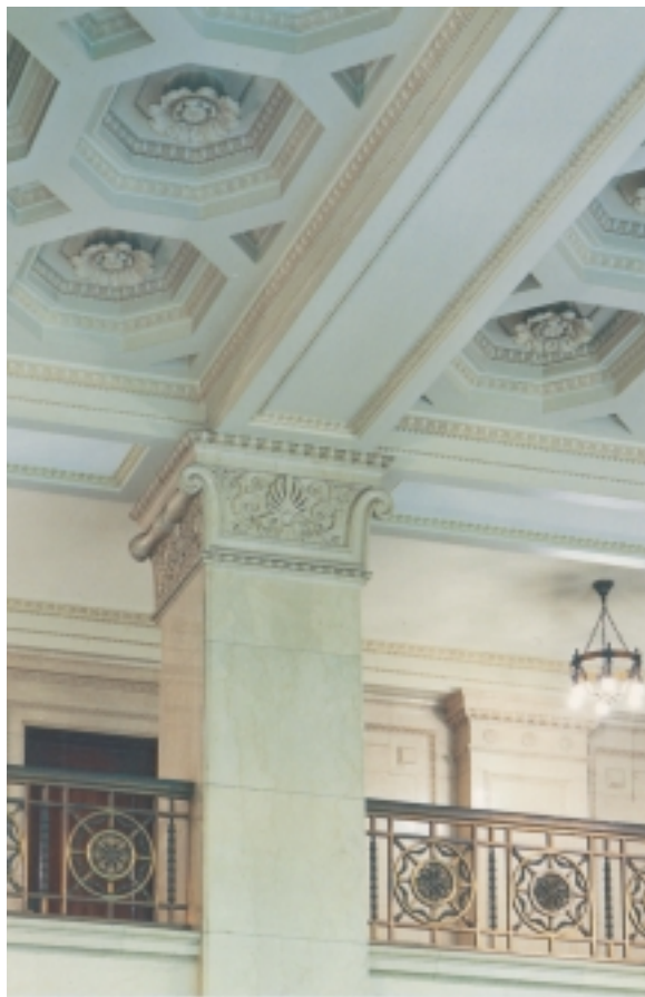
吹き抜けになっている一階営業店頭の柱と天井。 ここにも、装飾モチーフとしてアカンススの花模様がちりばめられている
